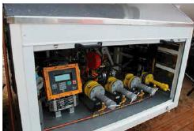
Заправочная установка FAS MID400
